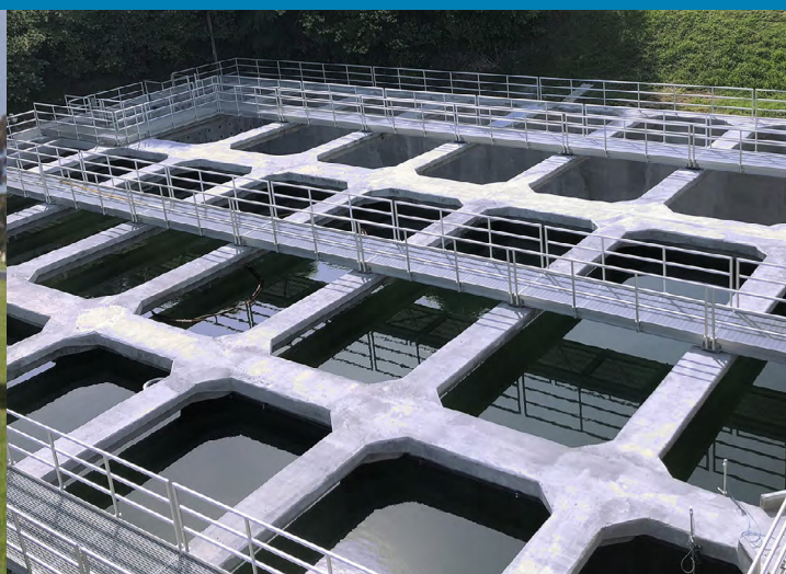
Megamix II: Impianto di Depurazione Mitchell - USA
